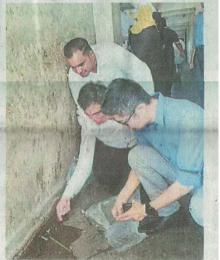
■走廊污水满地流, 也有蛆虫在地上爬动。
